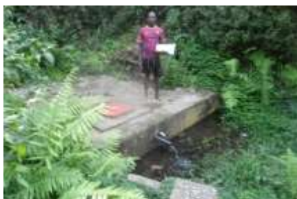
Photo 7 : Vue d'une source aménagée par la COTCO à Ebayega
