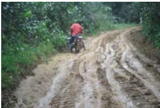
Photo 2 : Vue de l'état des routes de la Commune de Mvengue
