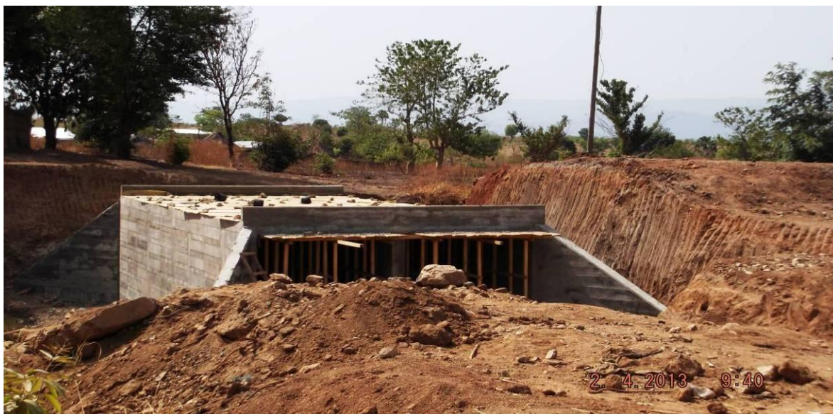
Photo 13 Travaux de reconstruction des ouvrages à l'entrée Sud de Mbé et de reconstruction de l'axe Ngaoundéré-Mbé-Garoua (AJLC 2013)
