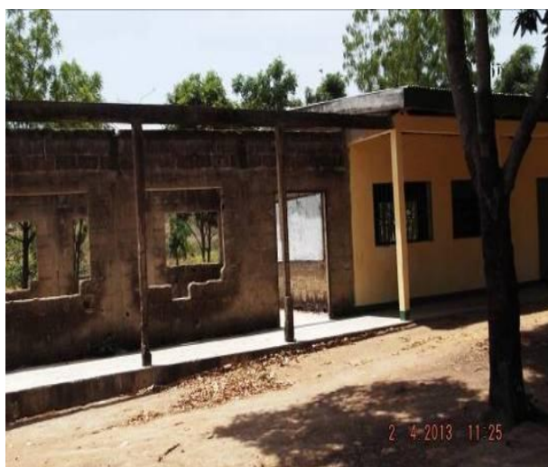
Photo 5 État des bâtiments de l'EP Groupe II de Mbé (AJLC 2013)
