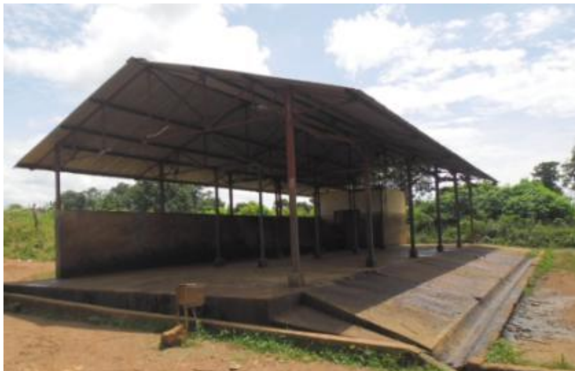
Photo 11. Abattoir municipal localisé au quartier Zandaba 1 L'infrastructure est dénuée de tout autre équipement de boucherie. La modernisation de cette structure est indispensable.
