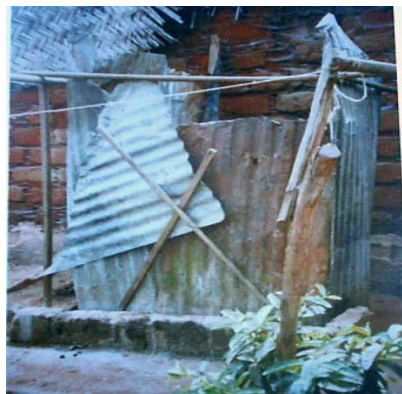
Photo 26: Latrine très sommairement aménagée en tôle de récupération.
