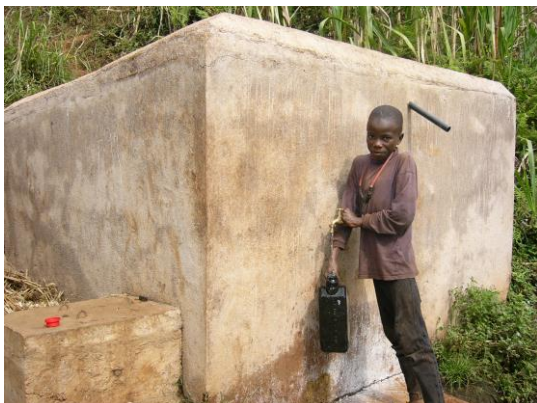
Photo 4 : Réservoir captage Keleng
