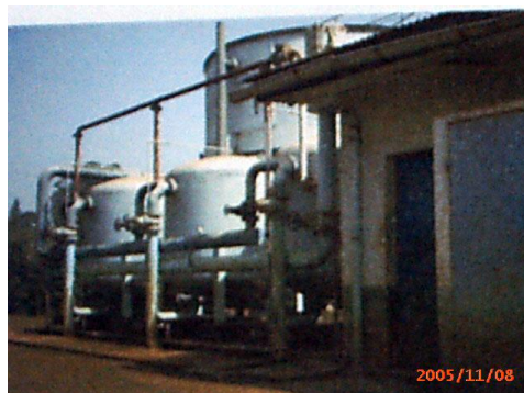
Photo 1 : Système de filtres à sable et graviers
