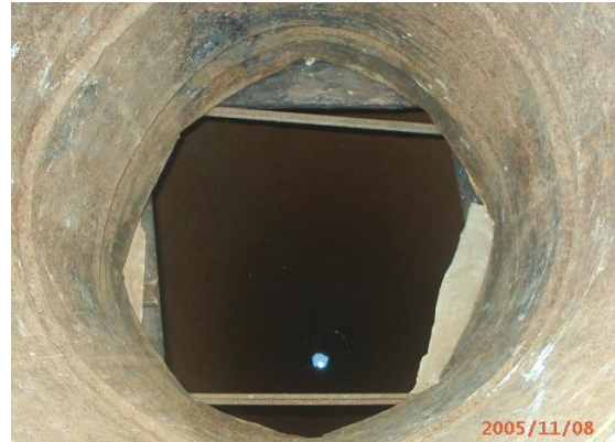
Photo 17 : Les parois ne sont pas protégées
