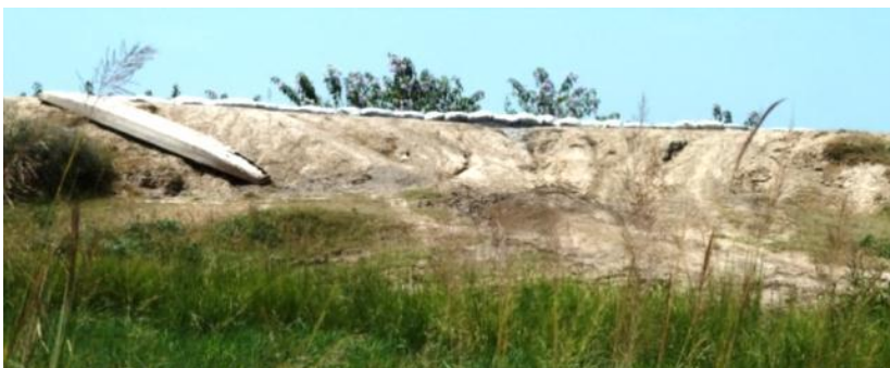
Figure 13. Érosion, causée par des débordements, ayant failli détruire le barrage de Maga
