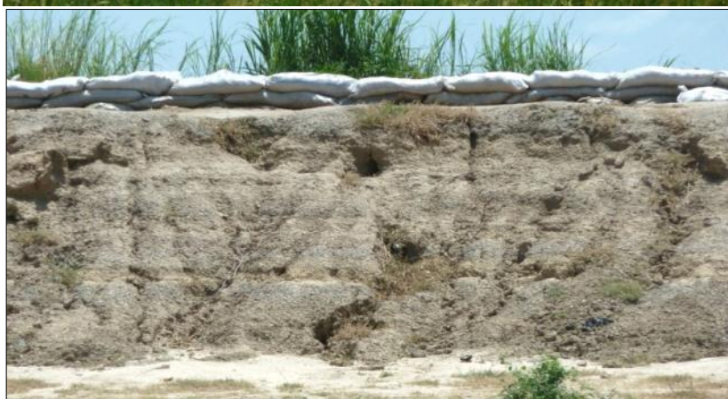
Figure 14. Formation de renards et d'infiltrations entre les couches du corps principal du barrage de Maga ; septembre 2012
